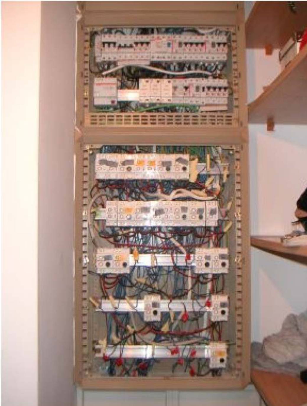
Rys. 4. Przykładowa szafa dystrybucyjna, zawierająca interfejs podłączona do jednostki sterującej
